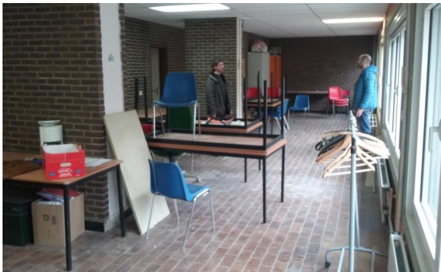
Luik D (huidige situatie): gemeenschapslokaal dat gerenoveerd moet worden
