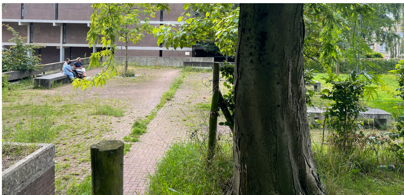
Dalles dégradées - Phase 2 Vervallen betonnen platen - Fase 2
