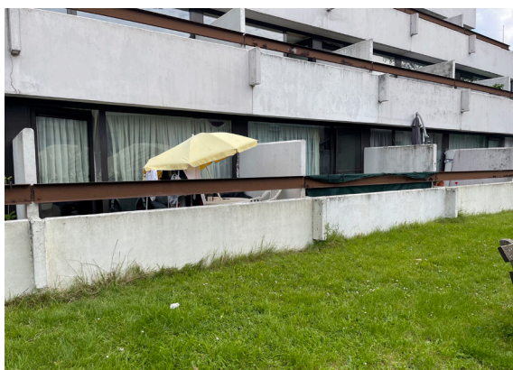
État dégradé - Phase 1 Slechte staat - Fase 1
