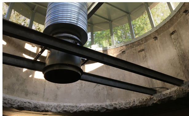
Les dômes de ventilation du parking du commissariat De ventilatiekoepels van de parkeergarage van het politiecommissariaat.
