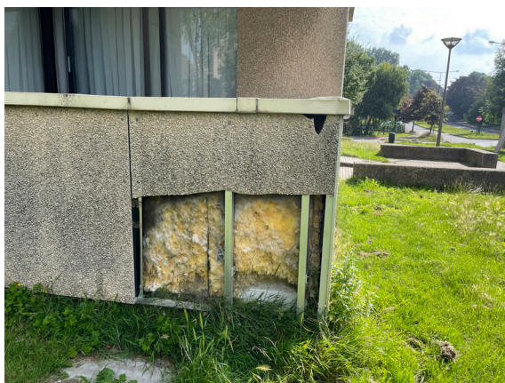
État dégradé - Phase 3 Slechte staat - Fase 3
