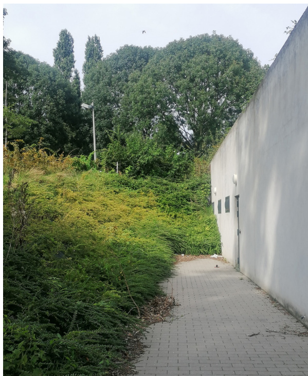
Espace moyennement dégradé - Salle agora Matig vervallen ruimte - Agorazaal
