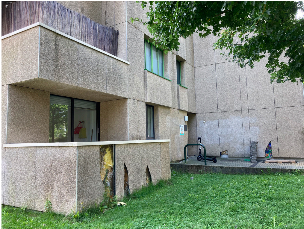
État dégradé - Phase 3 Slechte staat - Fase 3
