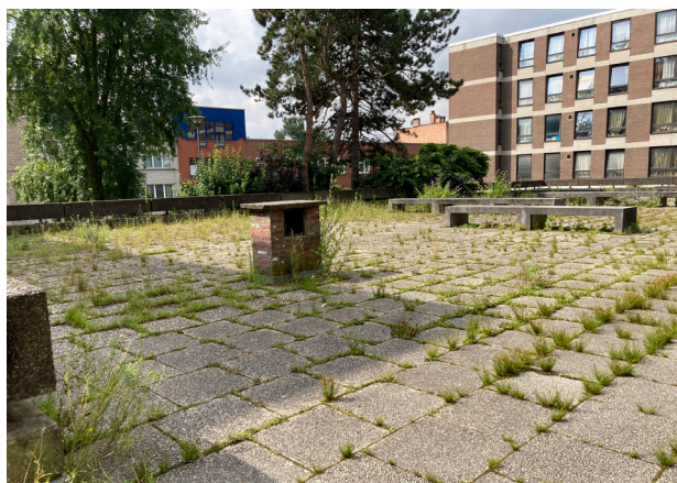
État des dalles - dégradé Staat van de betonnen platen -
