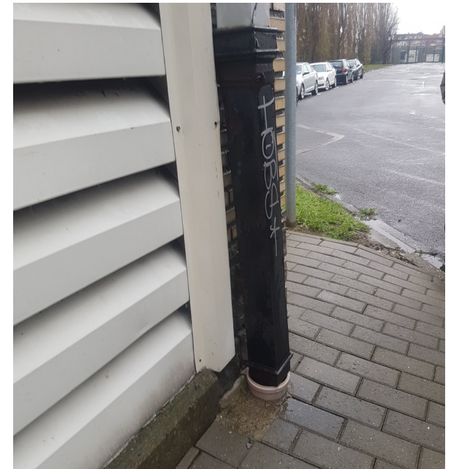
Regenwater afvoer - technische gebouw Elia bron: fotografie Árter ©
