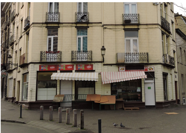
Voorbeeld van een handelszaak, het gelijkvloers is verlaten en in slechte staat
