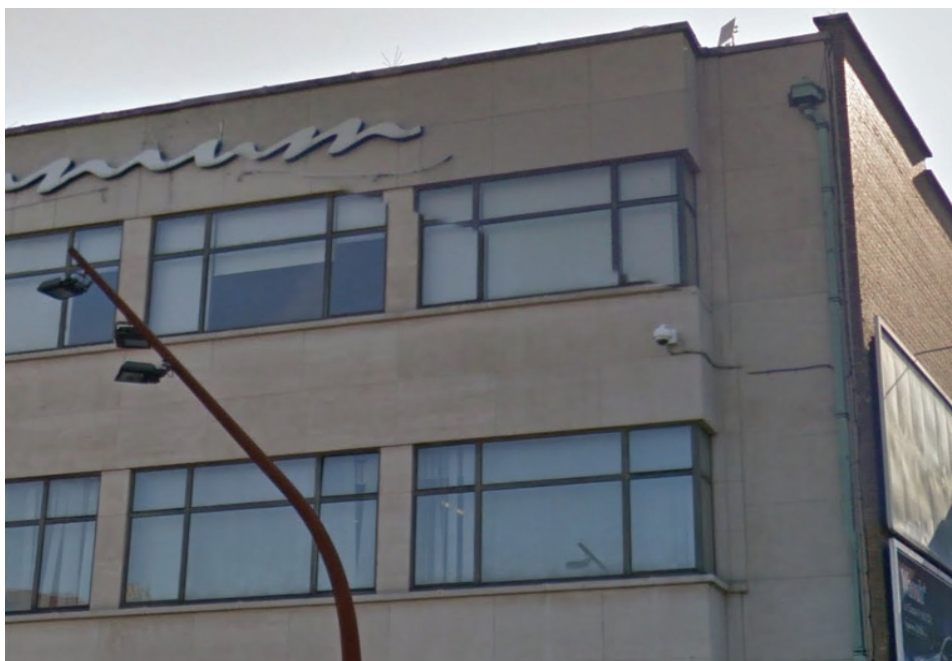
Twee camera's werden geïnstalleerd voor de verbetering van deze situatie
