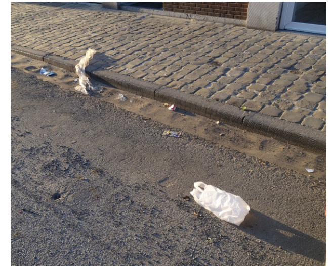
• Losliggende tegels - Weggevoerdenstraat
