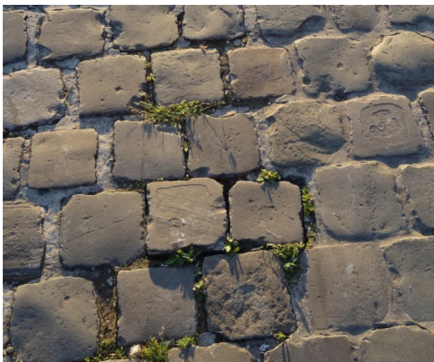
• Losliggende tegels - Weggevoerdenstraat Bron: foto EcoRes - mei 2015 ©
