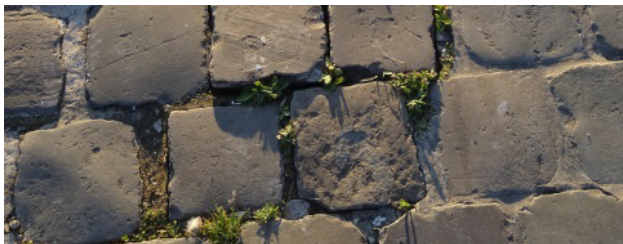
• Losliggende tegels - Weggevoerdenstraat Bron: foto EcoRes - mei 2015 ©
