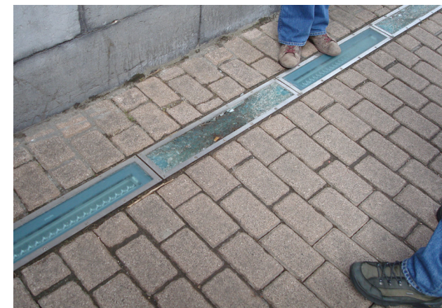
• Vandalisme aan de lichtinstallaties onder de brug van de Graystraat bron: foto Arter - maart 2013
