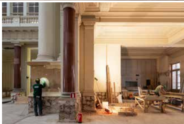
Chantier de restauration et réaffectation de la Bourse de Bruxelles, classée depuis le 19 novembre 1986, photo 2021. Séverin Malaud © urban.brussels
